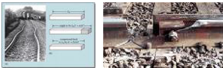
Rys. 12: Uszkodzenia szyn na skutek podwyższonych temperatur
